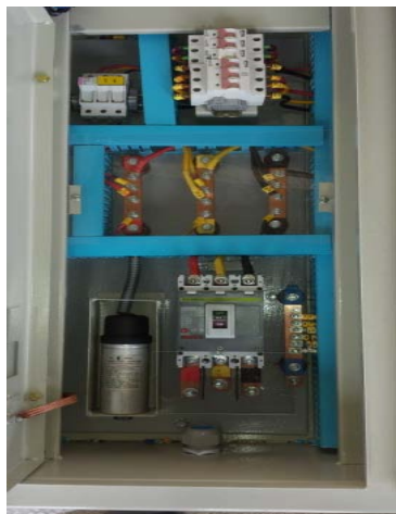
شکل (۲): نمایی از بخش ورودی تابلو و نحوه نصب خازن
